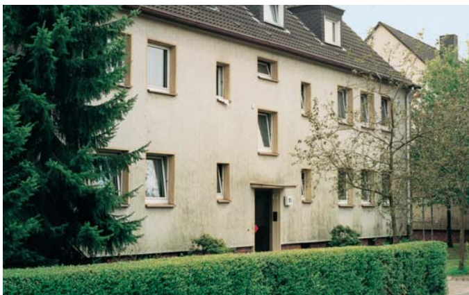
Příliš často jsou moderní fasády napadeny plísněmi již po krátké době.
