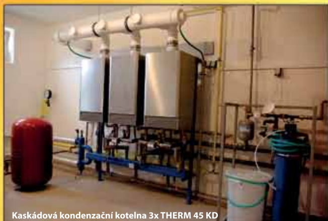
Kaskádová kondenzační kotelna 3x THERM 45 KD
