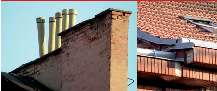
Ukázka špatného technického stavu budovy
